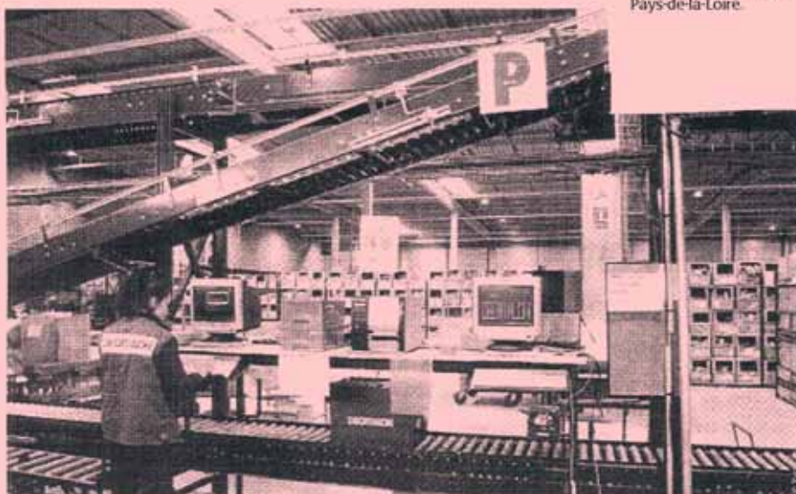
L'entrepôt est desservi par plusieurs circuits de convoyeurs de cartons. L'opératrice située au niveau de la gare de réception est particulièrement exposée au bruit généré par les rouleaux des convoyeurs
